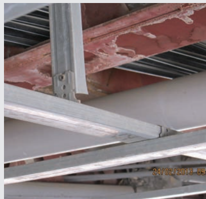
عدم اجرای جزئیات آویزگیری
