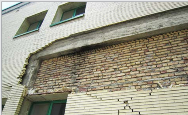
شکل ۱۴: ریزش قطعات آجر نما
