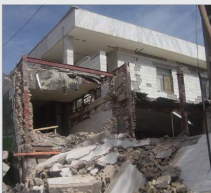
شکل ۵: تخریب کل ساختمان بر اثر فروریزی دیوارهای بنایی
