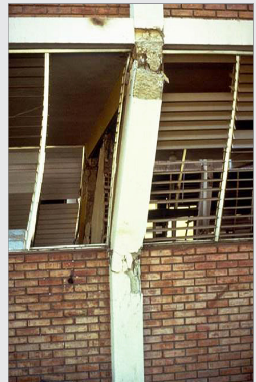
شکل ۹: شکست ترد برشی در ستون بتنی
