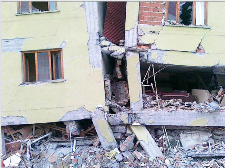
شکل ۸: تخریب ساختمان در اثر طبقه نرم زیرین
