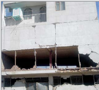
شکل ۳: انهدام خارج از صفحه دیوارهای بنایی
