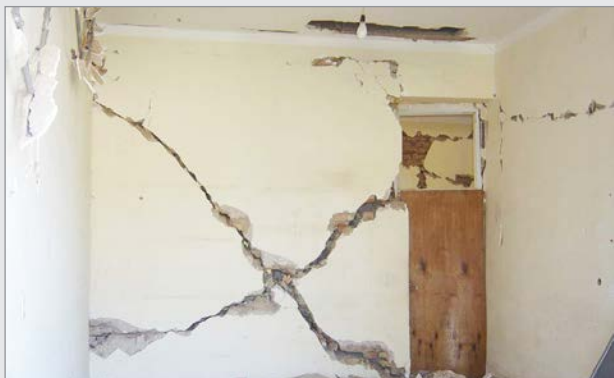
شکل ۱۳: شکست انفجاری دیوار بنایی
