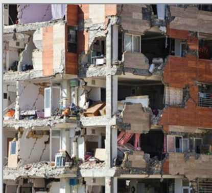
شکل ۴: مسکن مهر سرپل‌دهاب (زلزله سال ۱۳۹۶)
