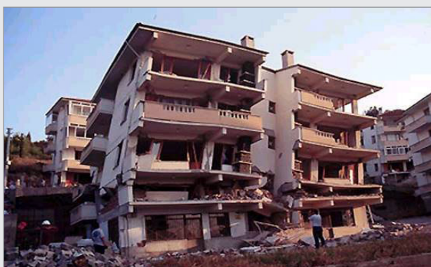
شکل ۱۱: تخریب در اثر حرکت پیچشی ساختمان
