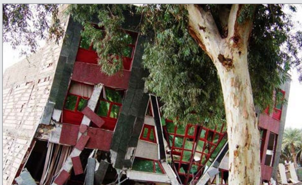
شکل ۱۵: ریزش قطعات سنگ پلاک
